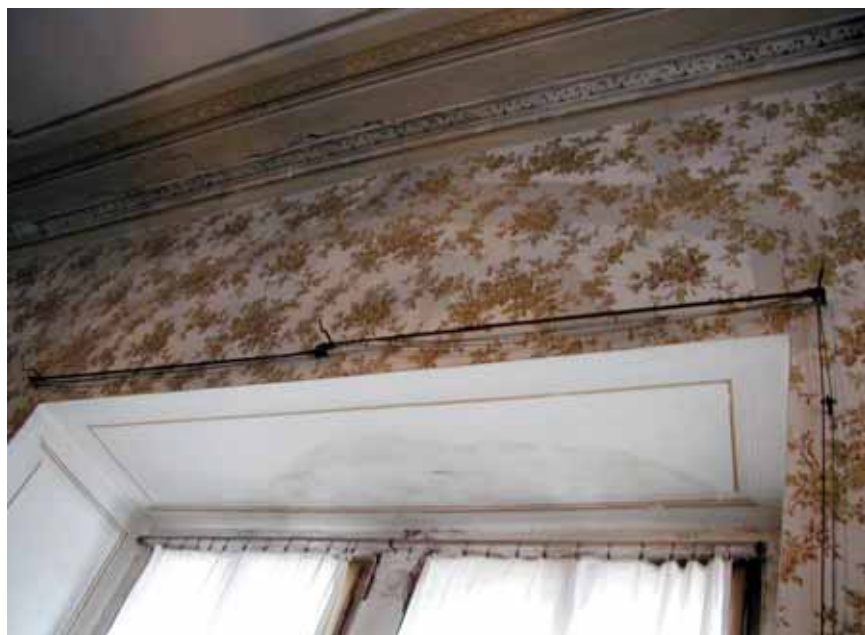
Obr. 5. Hrubý Rohozec (okres Turnov), zámek. Stav pokoje před rokem 2006, kdy sloužil jako depozitář, s dochovaným pojezdovým systémem včetně zachování porcelánových koncovek. Stejně pojezdové systémy se dochovaly v dalších místnostech zámku. Při instalaci byly ponechány na svém místě a byly na nich umístěny repliky závěsů.
