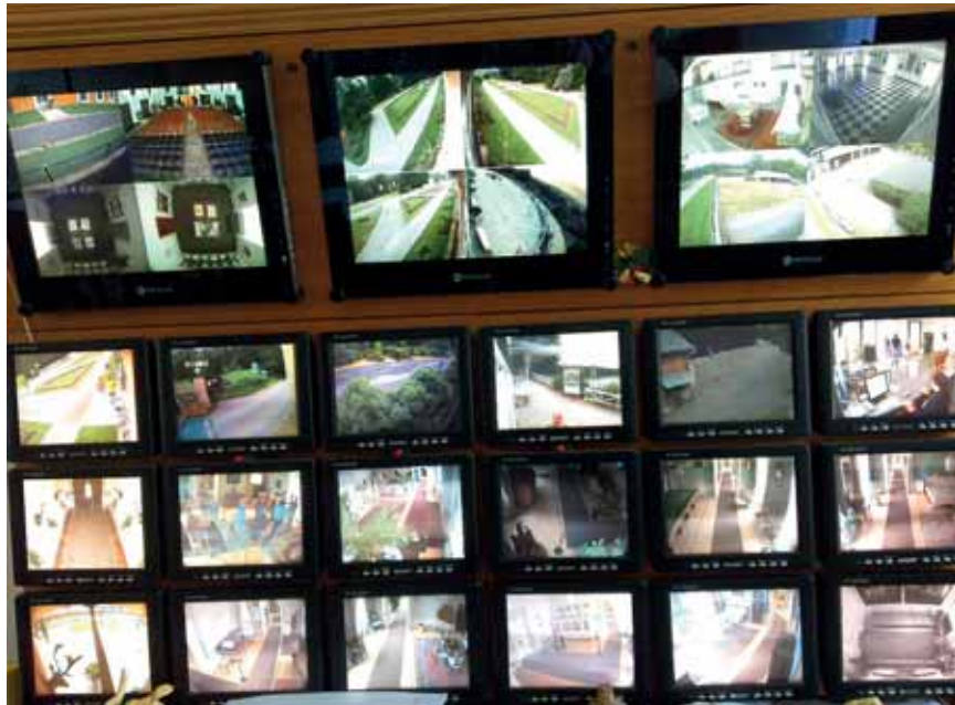
Obr. 7. Panel CCTV, kde jsou monitorovány a nahrávány sekvence v denním i nočním režimu.
